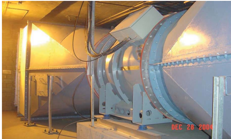
Tunnel Ventilation Fan
