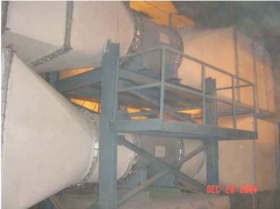
Trackway Exhaust Fan
